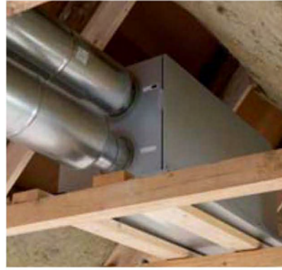
HCH установлена на чердаке
